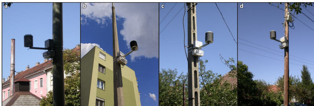
3. ábra: Néhány példa a mérőállomások elhelyezésére (a) acél és (b) beton kandeláberen, illetve (c) beton és (d) fa villanyoszlopon.
